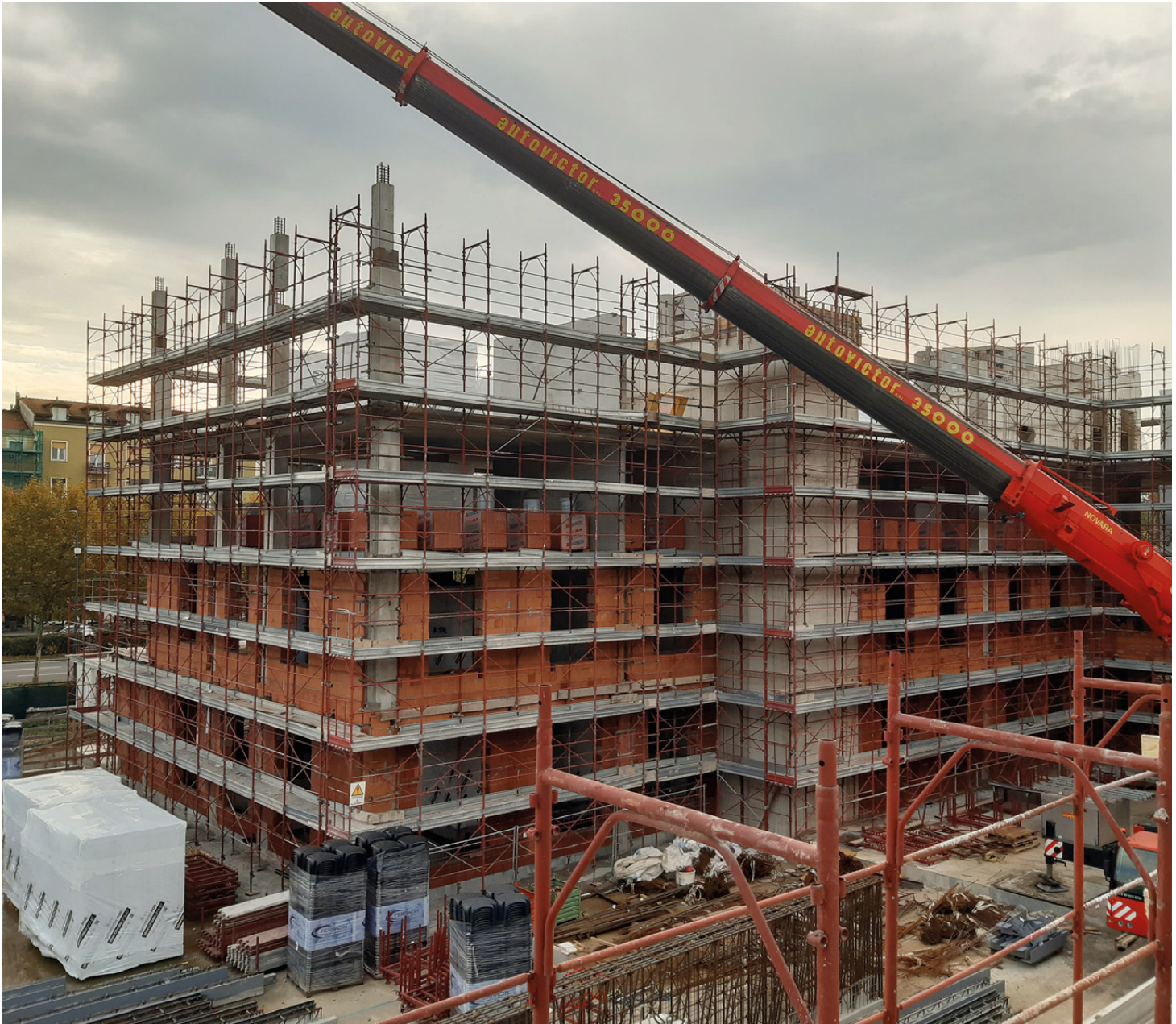
Il cantiere dell'edificio dell'RSA nella fase di completamento delle murature di tamponamento.
